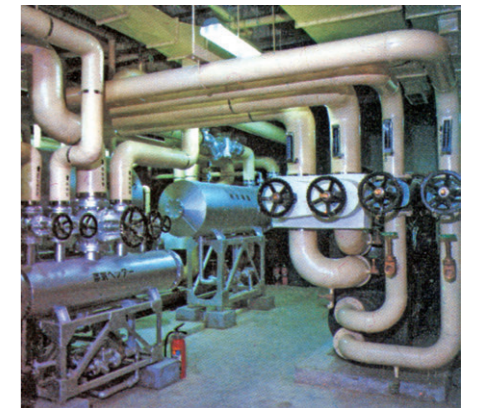
梁瀬空調設備の設備施工例
