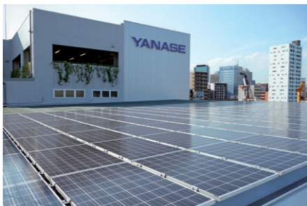
屋上に設置された太陽光パネル
