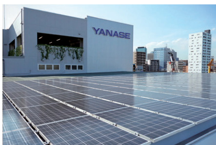
屋上に設置された太陽光パネル
